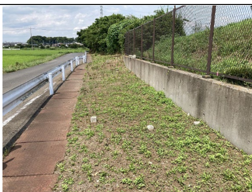
写真10. 場所③民家畑下（幅が拡張、杭が見える）
